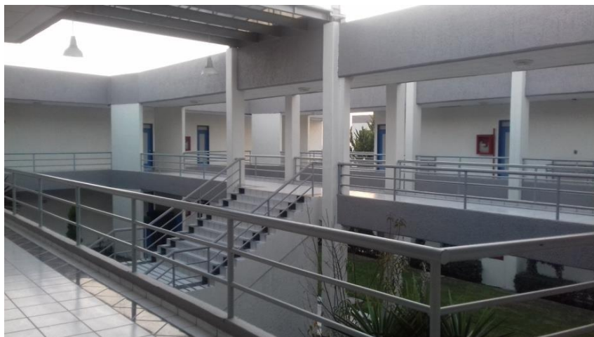
Figura 24. Pintura al módulo 1 de la ESTi.
