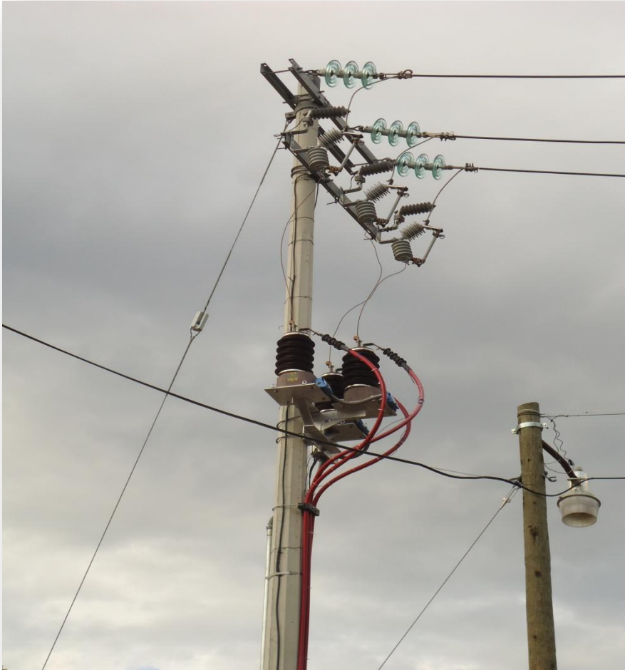
Regularización del suministro de energía eléctrica.
