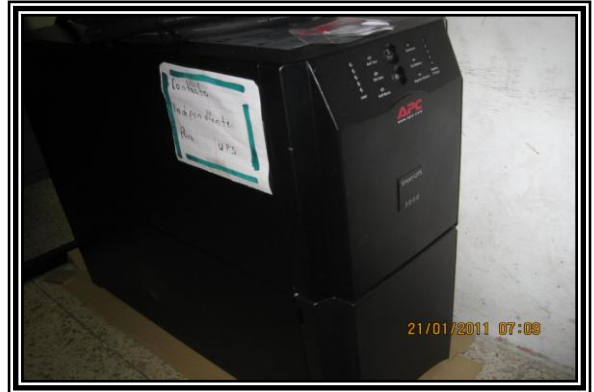
Biblioteca de la Escuela Preparatoria Número Tres. Regulador Smart UPS 3000. 18 de enero de 2011
