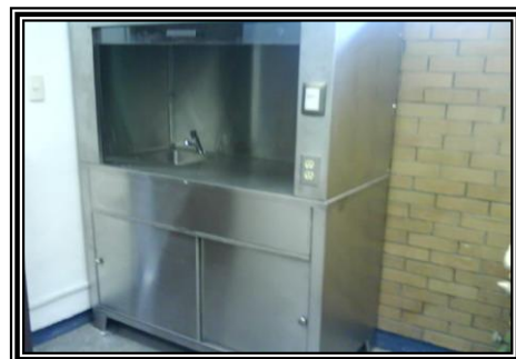
Campana extractora de gases
