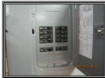
Caja de carga de luz instalada en la Biblioteca de la Esc. Preparatoria núm. Tres. 26 de enero 2011
