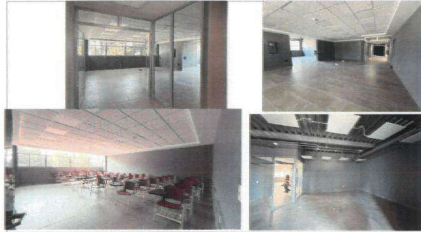
FOTOGRAFÍA 2 (F2). 1er Nivel Conclusión de trabajos de acabados: pintura, castellers, plafones, instalaciones, y limpieza
