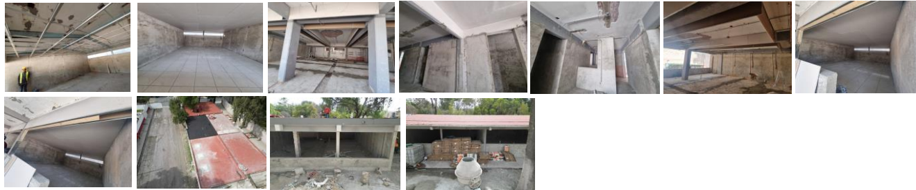
Fotos: Continuación de trabajos de aplanados en muros y plafones, suministro y colocación de pisos; implementación de instalaciones; trabajos de impermeabilización.
