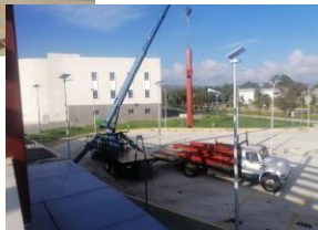
F1: Suministro y colocación de estructura de acero en 2do nivel de edificio existente.
